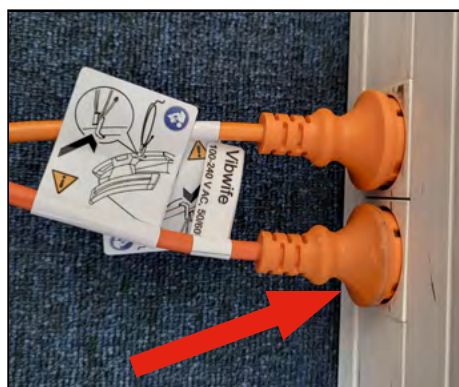
Fig. 31 Cable de red
